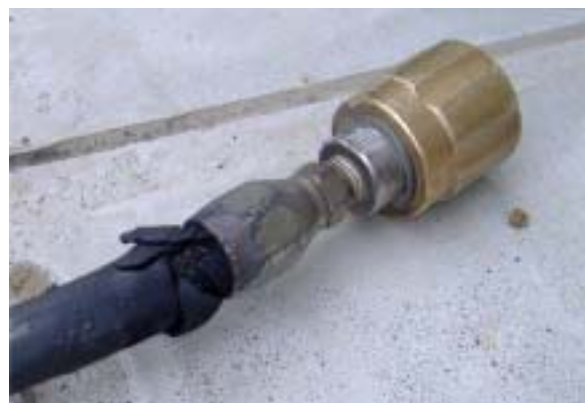
図9 ガスホース，コネクター側の損傷状況
